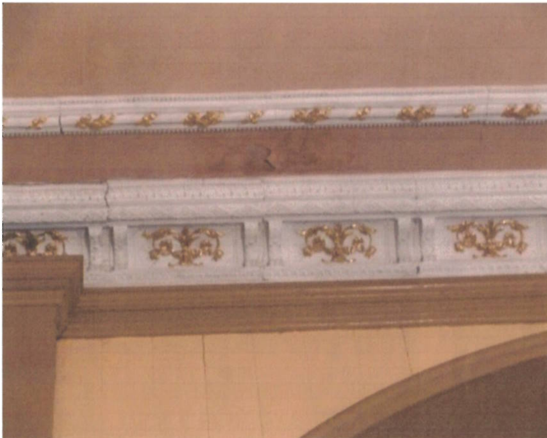
Ślady po zalaniu, spękania łączeń na sztukateriach
